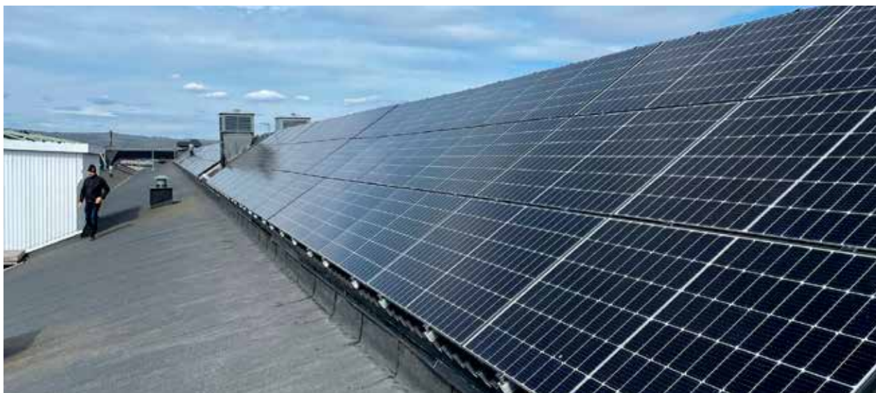
Örnsköldsviks största solcellsanläggning installerades på Hägglundsområdet i Gullänget. En investering på drygt 4,5 mkr. Toppeffekten ligger på 499kwp och beräknas årligen producera 415Mwh, vilket i sin tur reducerar klimatpåverkan med 195 ton koldioxid per år.
