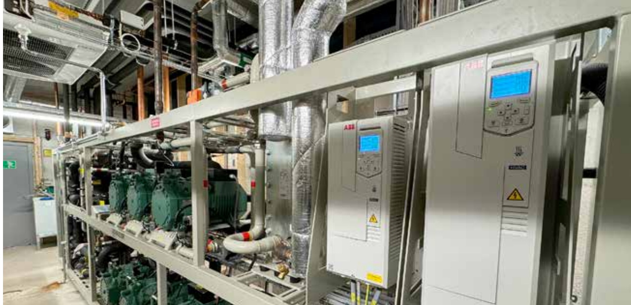
Dingersjö 3:58 i Sundsvall, konvertering av värmesystem, byte från flis till bergvärme.
